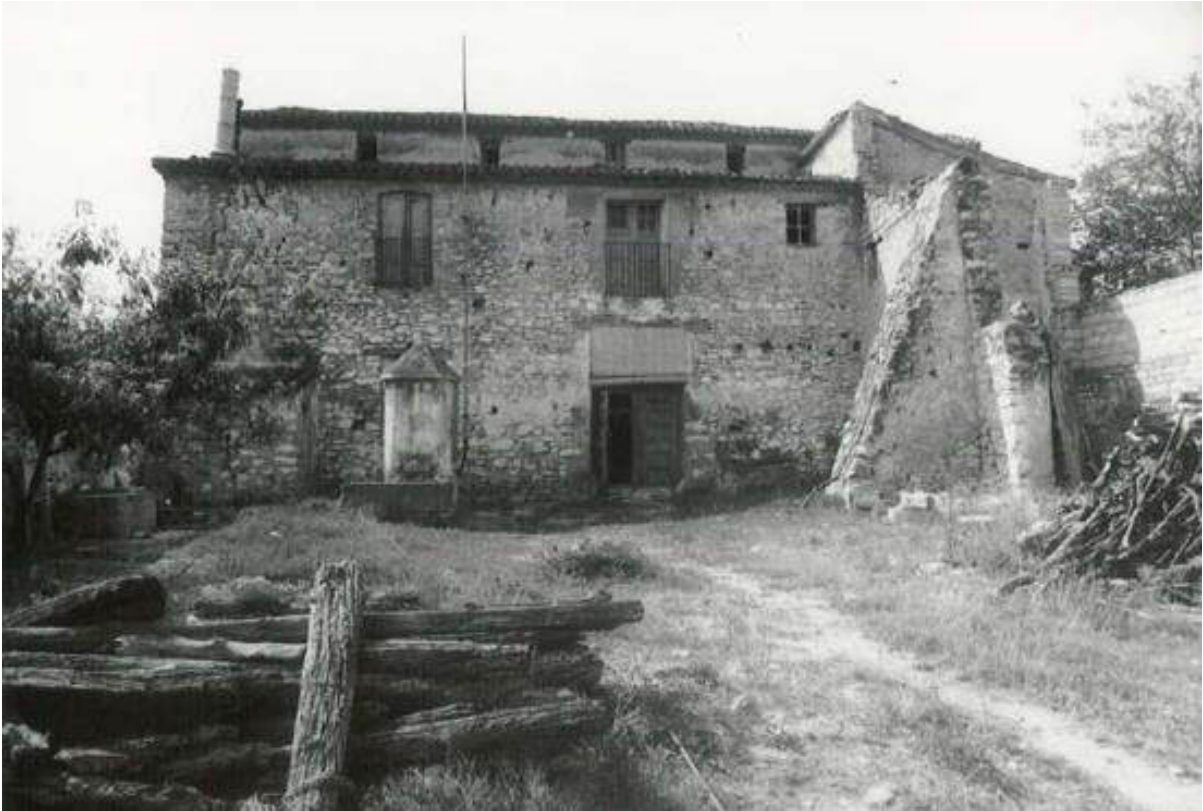
Imagen 12: Imagen del estado de la edificación. Fuente: Ficha IPCE (1979 en adelante)
